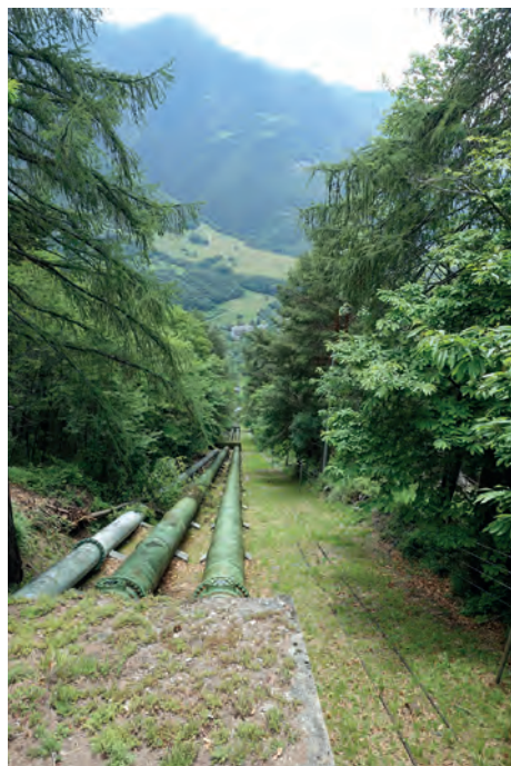
Le condotte forzate della centrale di Isollaz
